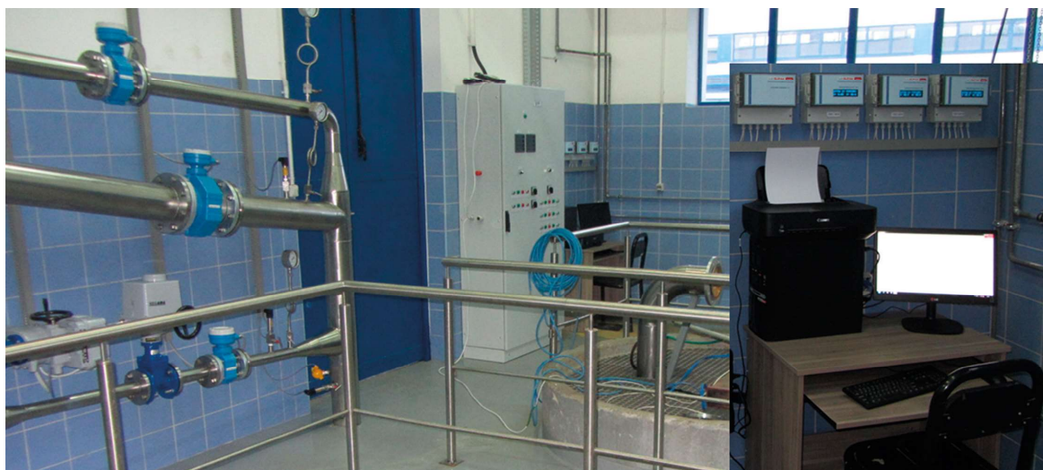
FOT. 1. Widok przykładowej stacji prób
